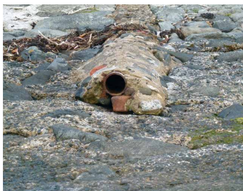
FIGURA A6.4 TUBERÍA EN DESUSO
