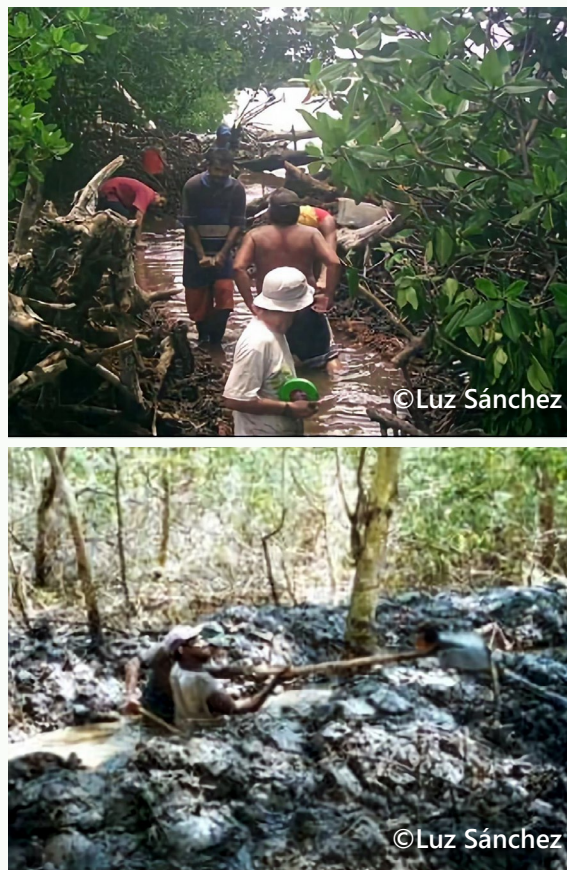
Figura 4. Restauración de la dinámica a partir de la activación de canales secundarios
