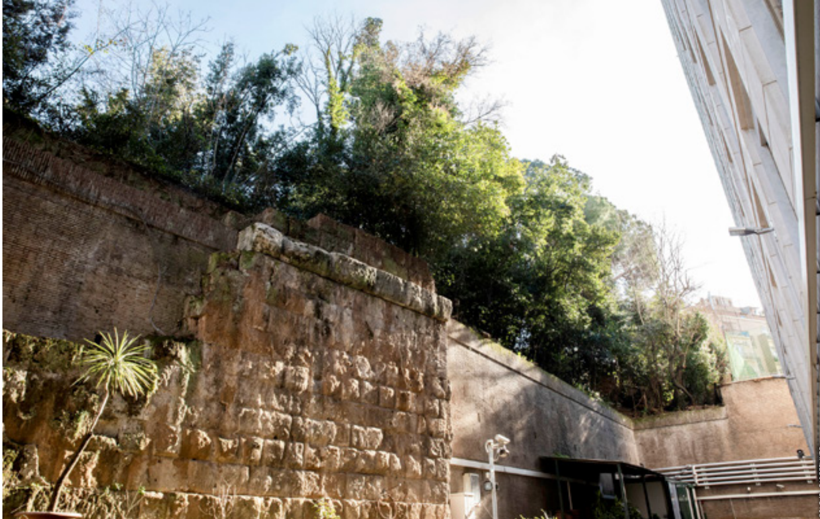
Mur de soutènement romain en appareil rectangulaire ( opus quadratum ) en tuf et en travertin, remontant au II e siècle av. J.-C. et visible derrière le bâtiment C du complexe de la FAO.
